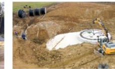
05 Mithilfe eines Baggers werden die Leitungen in die Leerröhre des Fundaments eingezogen.
